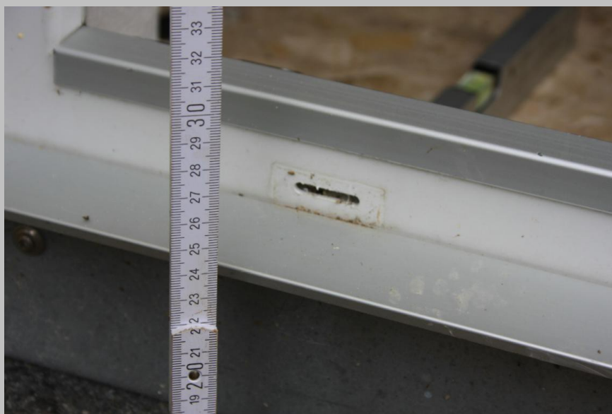
Bild 1: Maß vom Rohfußboden bis zur Höhe der Entwässerungsöffnung an der neuen Türe.
