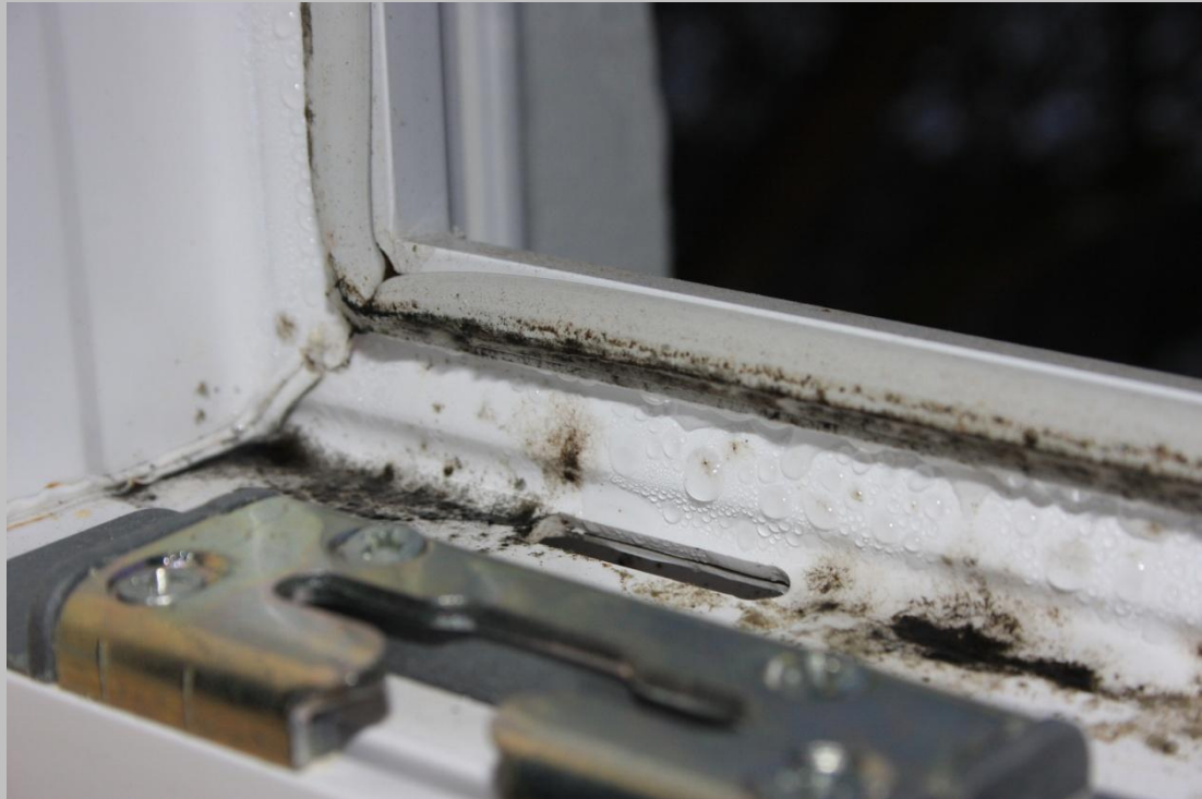
Bild 1: Kunststoff-Fenster mit innerer Überschlagsdichtung. Kleinste Fugen an der Dreh-Kipp-Schere reichten aus um diesen Schaden entstehen zu lassen. Die rel. Luftfeuchtigkeit im Haus lag bei 41 % bei +21°C Zimmertemperatur
